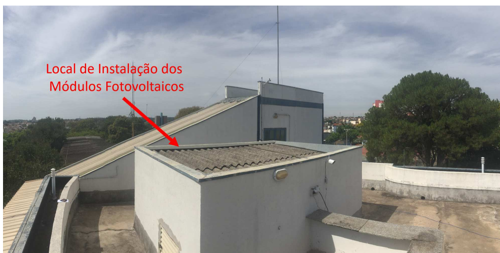
Figura 6.4: Detalhe do local de instalação dos módulos fotovoltaicos.
