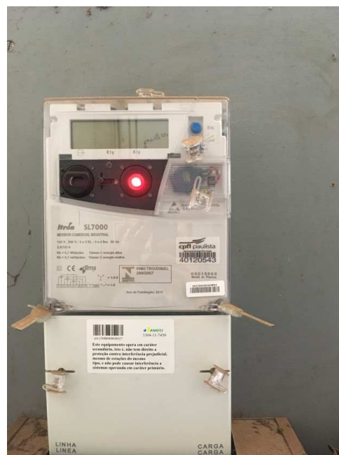
(b) Medidor de Energia - Fabricante: Itron - Modelo: SL7000.
