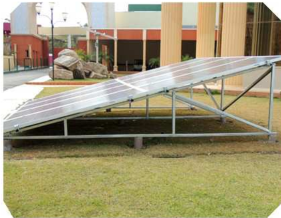
Figura 6.6: Detalhe da estrutura de aço galvanizado para suporte dos módulos fotovoltaicos.
