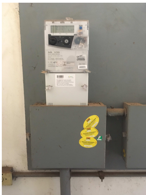
(a) Medidor de Energia.
