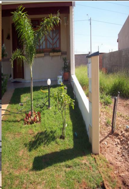
Pedestal lateral entrada BT subterrânea
