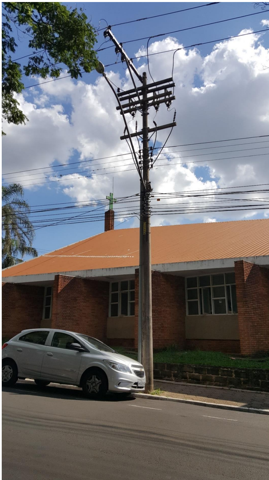
Figura 11: Poste de conexão entre ramal de entrada e rede de distribuição, localizado na rua Miguel Petroni.
