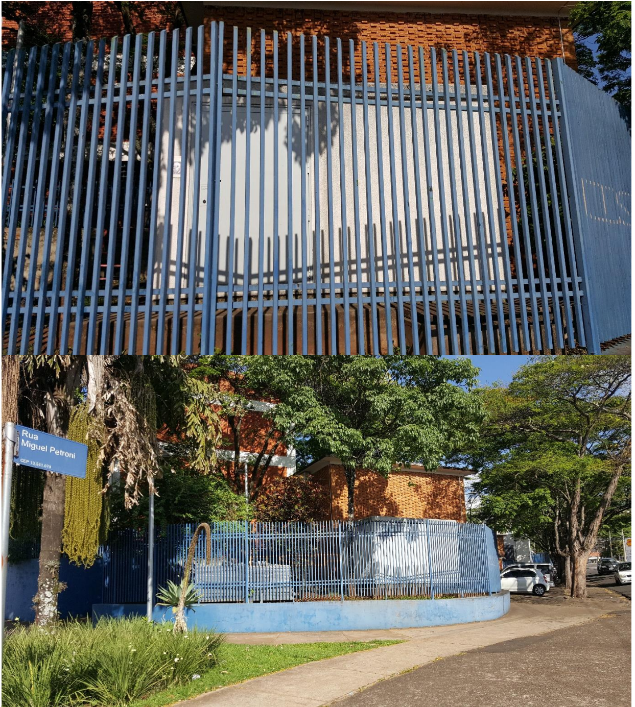
Figura 12: Cabine metálica do ramal de entrada.
