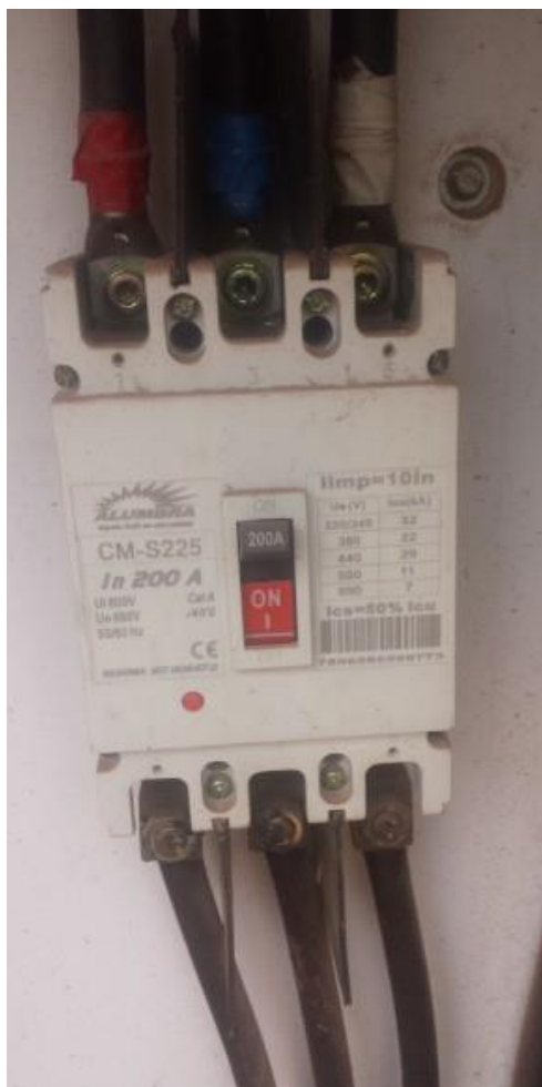
Disjuntor Tripolar 200 Amperes
