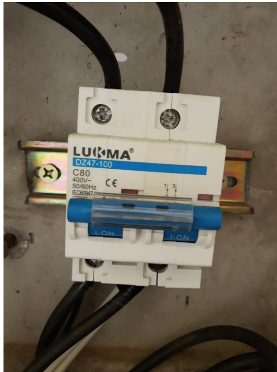
Disjuntor Bipolar de 80 Amperes
