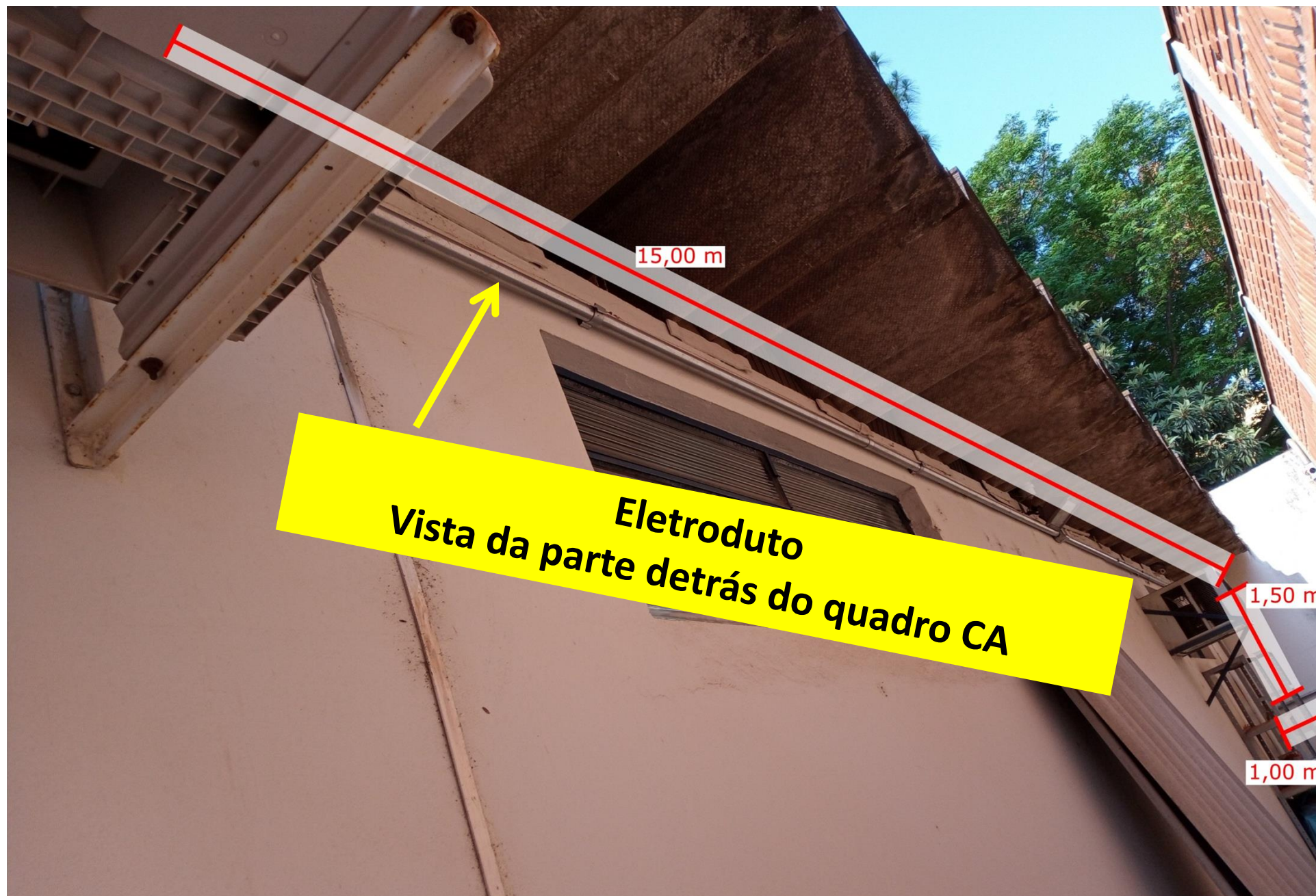
Fig 3: Vista da parte de trás do quadro de distribuição CA -eletroduto
