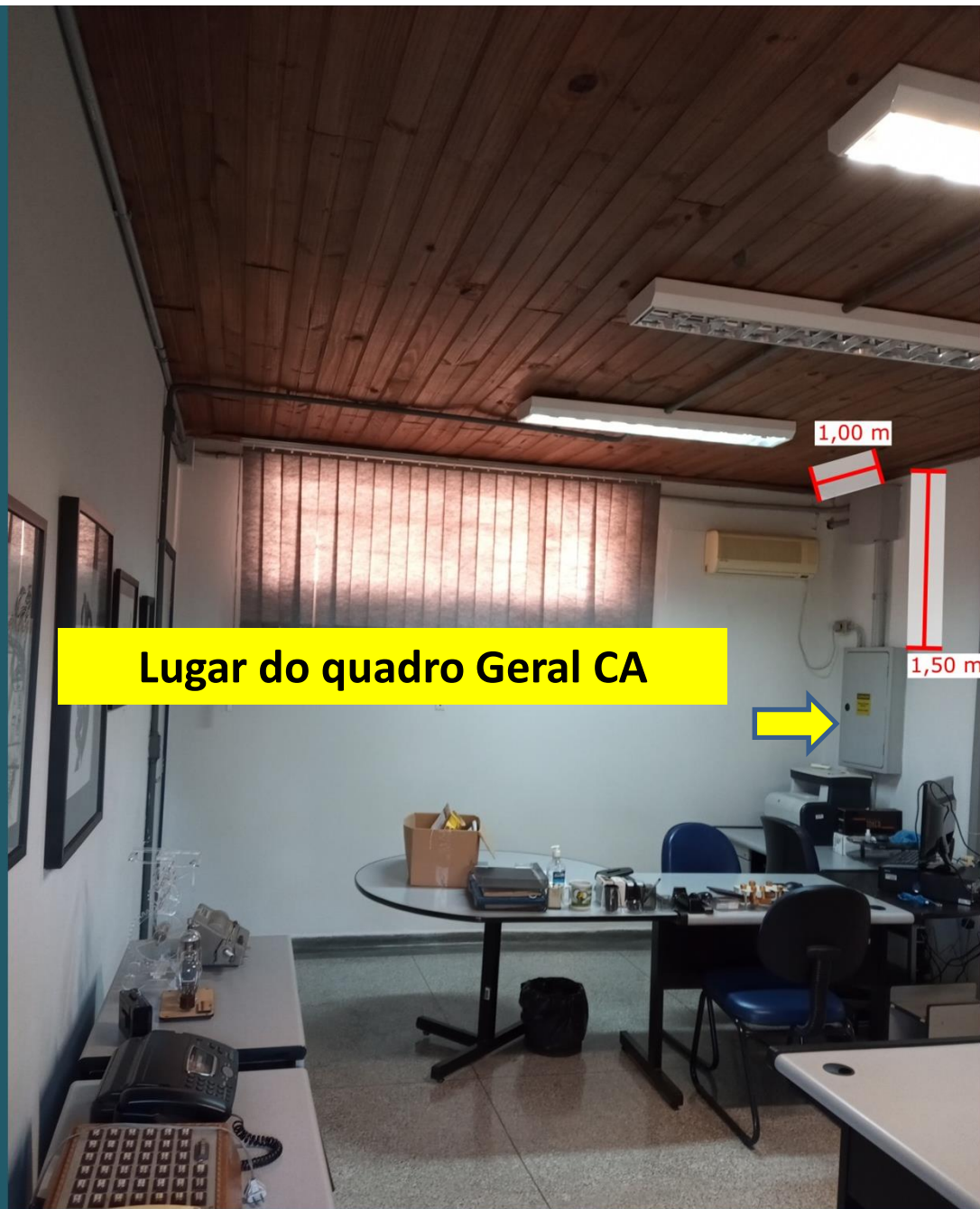
Fig 4: Vista do quadro Geral (principal) CA 220V (trifásico)
