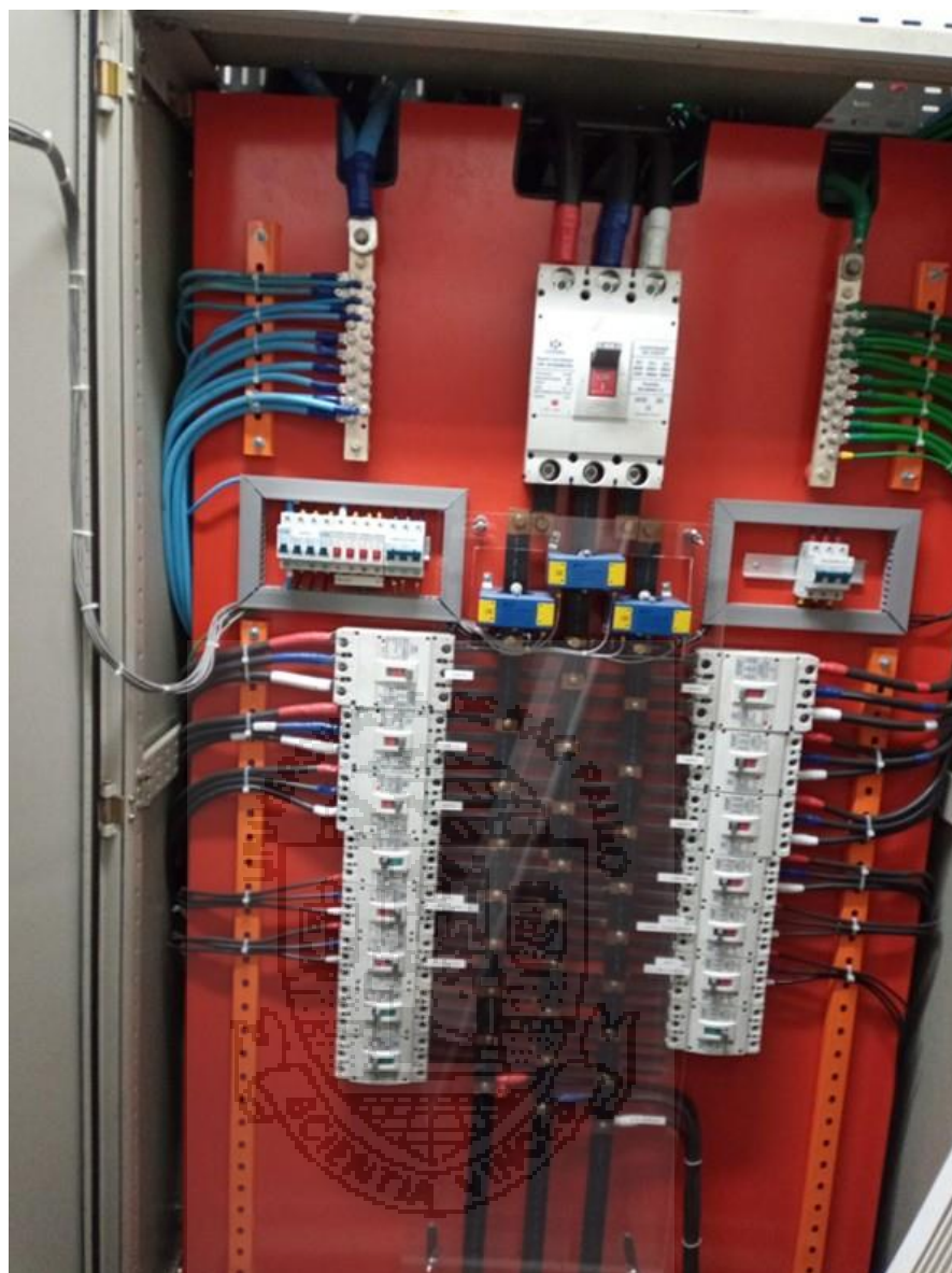
Figura 36: (EESC-PROD) Quadro de Distribuição principal CA, 220V.
