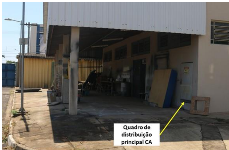
Figura 120: (PUSP-SC - SEVe) Quadro de distribuição principal CA (parte externa do prédio).
