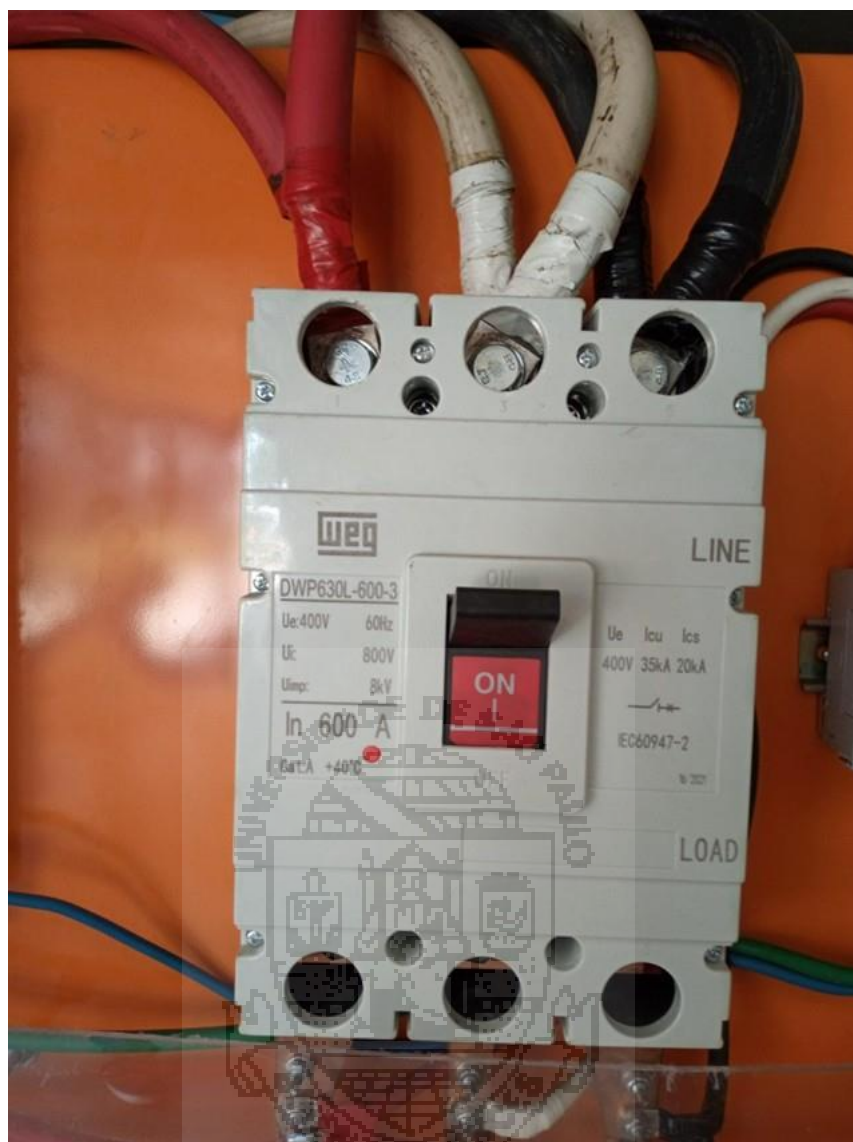
Figura 49: (EESC - CETE) Disjuntor do Quadro de Distribuição Principal CA, 220V.
