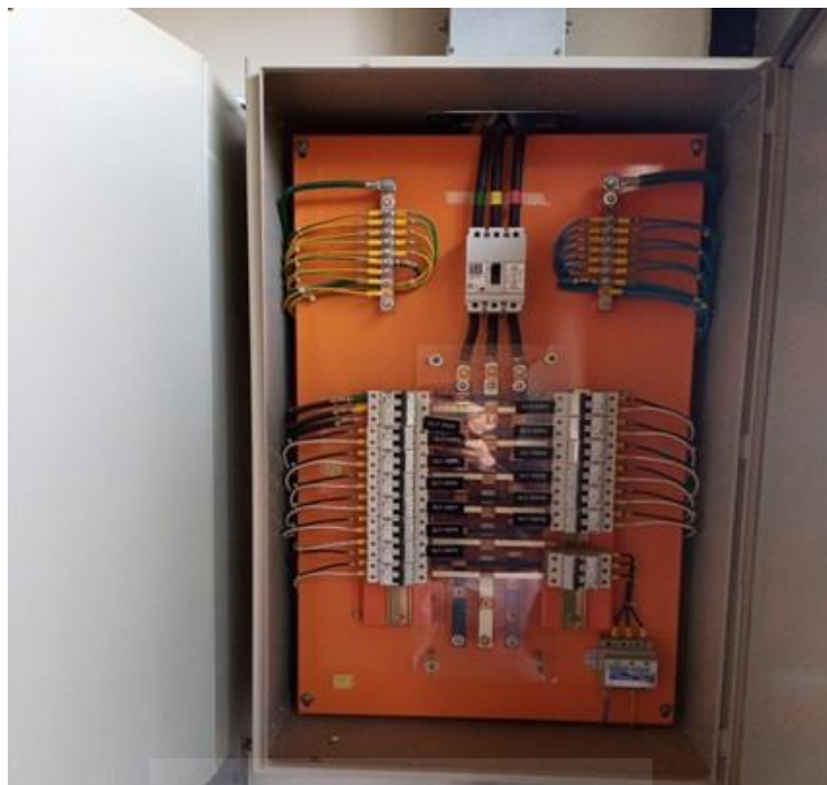
Figura 42: (EESC-SELN) Quadro de Distribuição principal CA, 220V (a).
