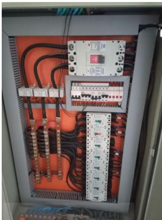
Figura 28: (EESC-Bib) Quadro de Distribuição principal CA, 220V.
