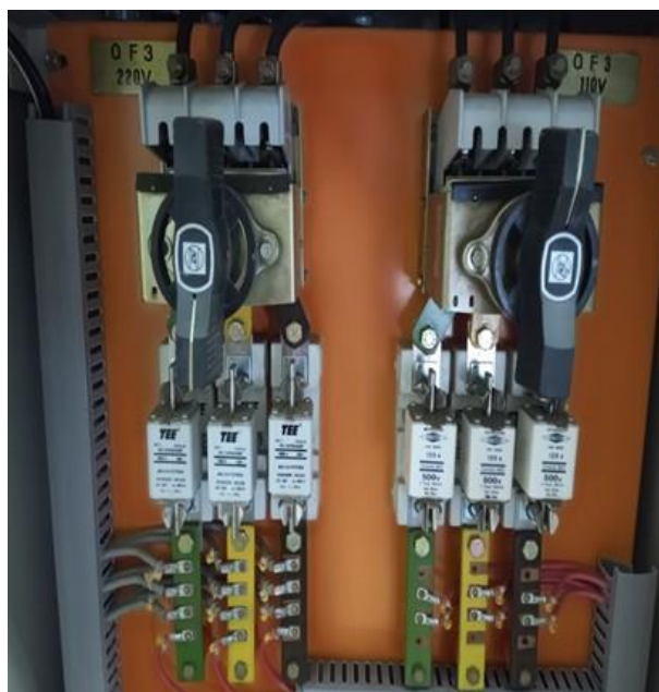
Figura 113: (IFSC – LabDida) Chave seccionadora do Quadro de Distribuição Principal CA, 220V.
