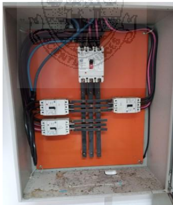
Figura 85: (IFSC-LabPes) Quadro de Distribuição principal CA, 220V.
