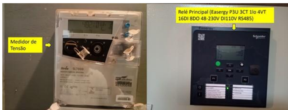
Figura 10: Relé e Medidor de Tensão dentro da IFSC II.
