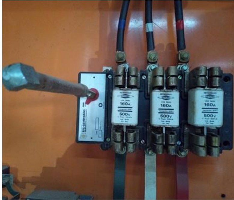
Figura 66: (EESC-Marc) Fusível do quadro principal CA.
