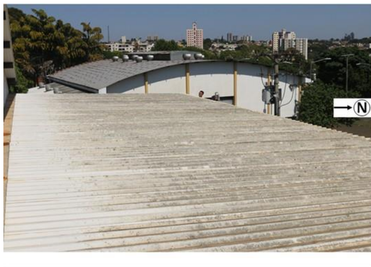
Figura 117: (PUSP-SC - SEve) Vista do lugar da instalação (parte 2 – parte superior).
