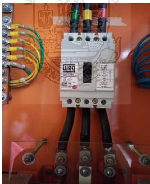
Figura 43: (EESC-SELN) Disjuntor do Quadro de Distribuição Principal CA, 220V (b).
