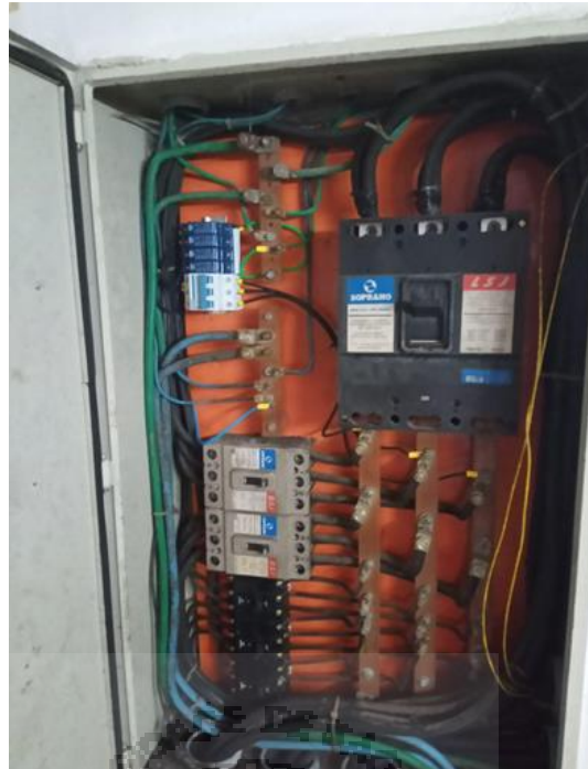
Figura 72: (IQSC - Q5) Quadro de Distribuição principal CA, 220V.
