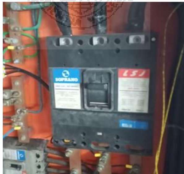
Figura 73: (IQSC - Q5) Disjuntor do Quadro de Distribuição Principal CA, 220V.
