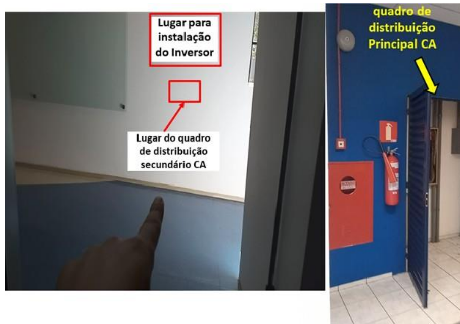
Figura 99: (IFSC - C) Lugar do Inversor e o Quadro de distribuição principal CA.
