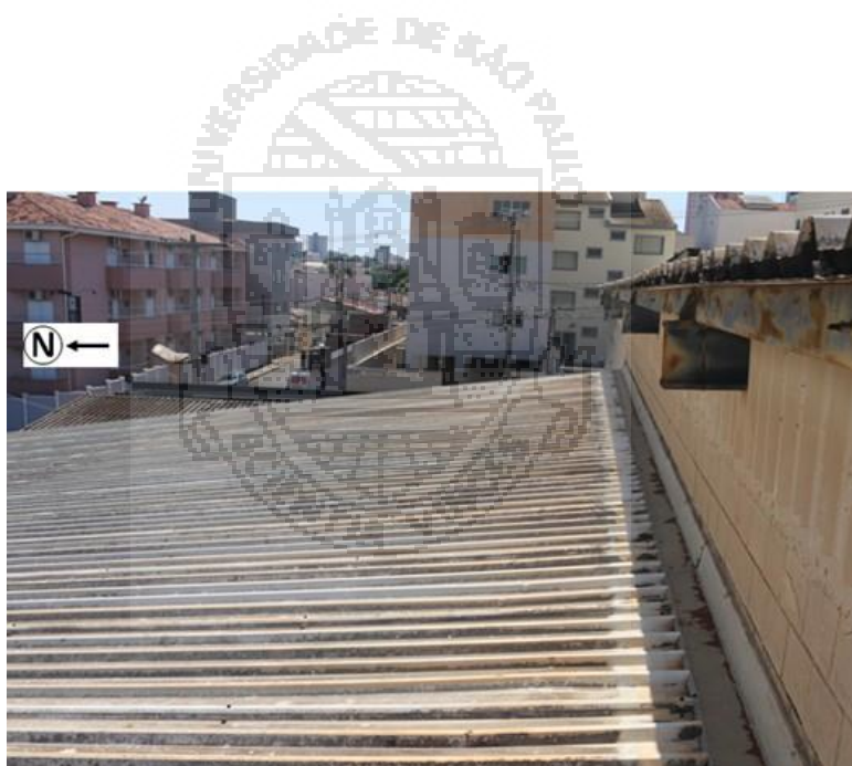
Figura 116: (PUSP-SC - SEVe) Vista do lugar da instalação (parte 1- parte inferior).
