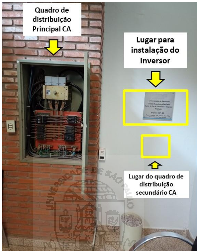
Figura 55: (EESC-TRAN) Quadro de Distribuição principal CA, 220V.
