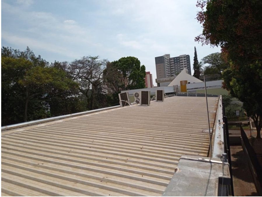
Figura 44: (EESC - CETE) Vista do lugar da instalação.
