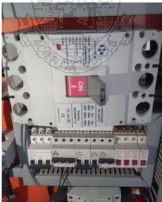
Figura 29: (EESC-Bib) Disjuntor do Quadro de Distribuição Principal CA, 220V.
