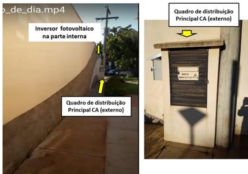
Figura 128: (PUSP-SC - MiniAlm) Lugar do Quadro de distribuição Principal CA (externa).
