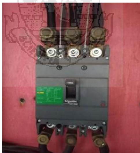
Figura 107: (IFSC – A) Disjuntor do Quadro de Distribuição Principal CA, 220V.
